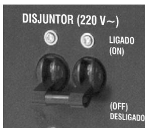
Figura 13 – Disjuntor do Circuito CA
