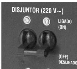
Figura 13 – Disyuntor del Circuito CA
